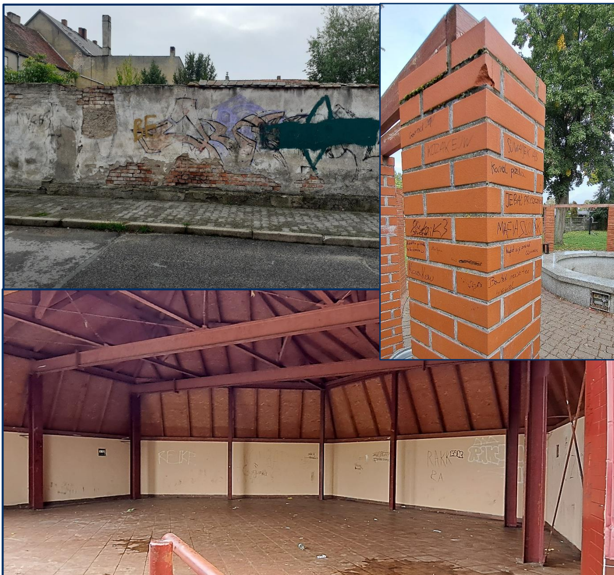
Rysunek 5. Przykłady aktów wandalizmu na obszarze rewitalizacji: graffiti na jednym z murów przy ul. Parkowej oraz w parku przy ul. Lipowej w Słońsku.
