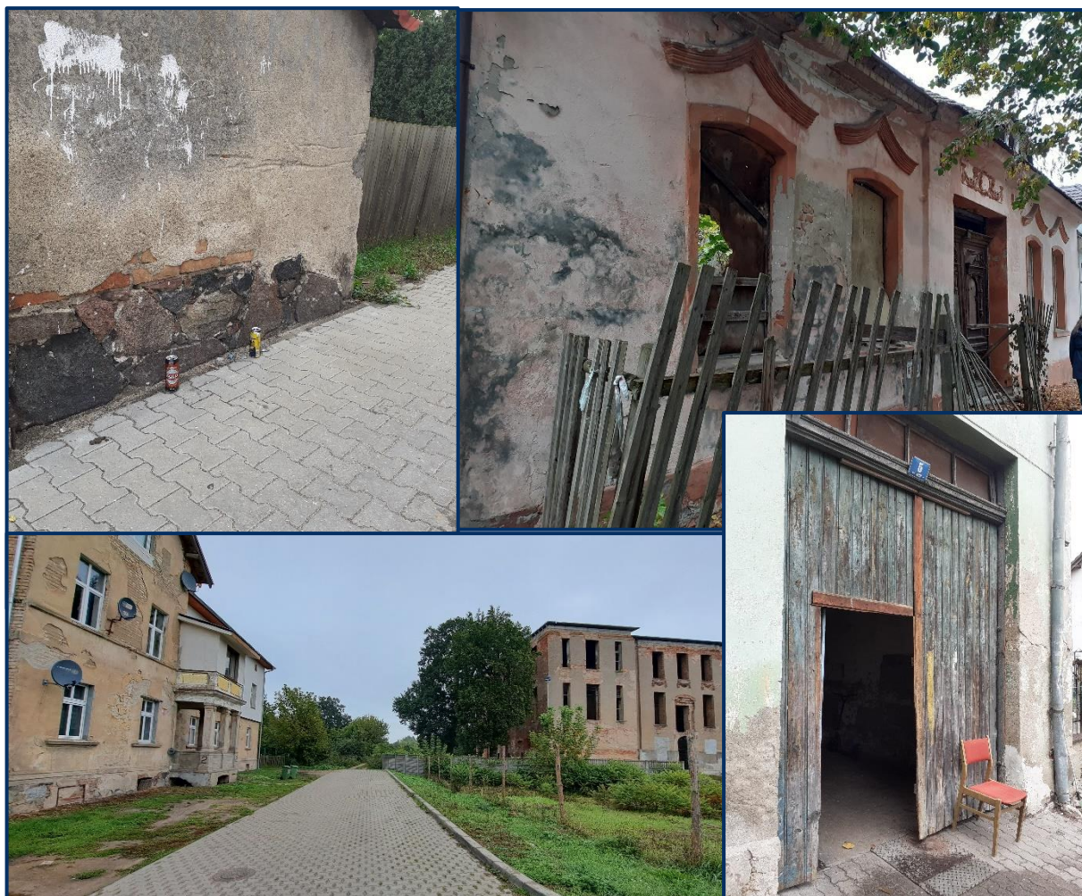
Rysunek 15. Stan techniczny wybranych budynków w podobszarze rewitalizacji Słońsk 1 (od lewego górnego rogu: ul. Parkowa, ul. Graniczna, Plac Wolności, ul. Graniczna).
